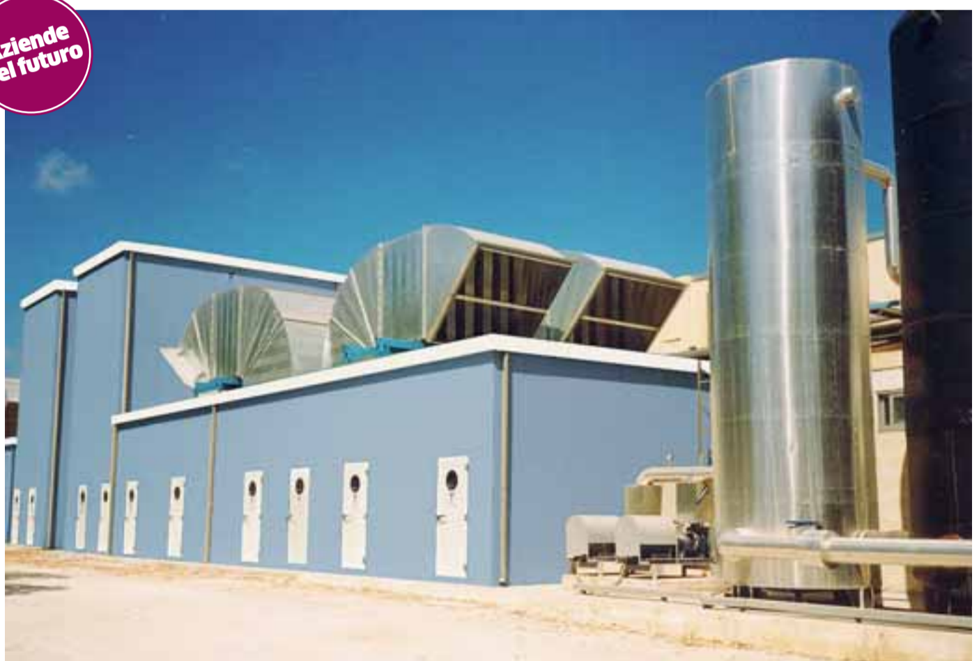
Una centrale di condizionamento progettata dalla Martèl analoga a quelle che verranno installate nel polo petrolchimico brasiliano
